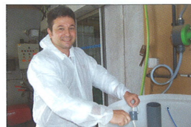
► Joël Leduc montre la cuve de stockage de la solution Enviolyte, dont la production est commandée par un flotteur qui mesure le niveau.
