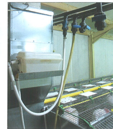
▲ Dans le bâtiment principal de l'élevage, qui compte 3 bandes, les 6 salles sont équipées en bacs tampons et alimentées en eau par trois circuits commandés par des pompes doseuses.
